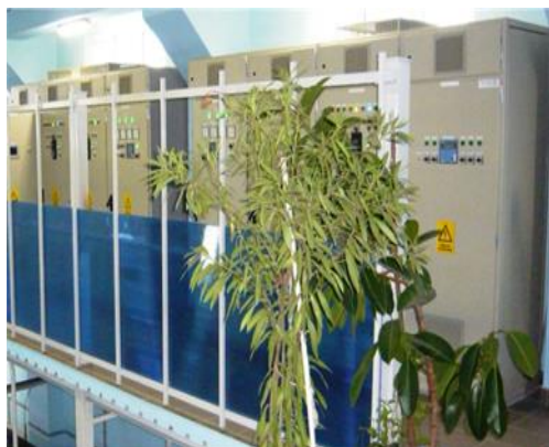
SCADA Turnul de apa (foto 7)
