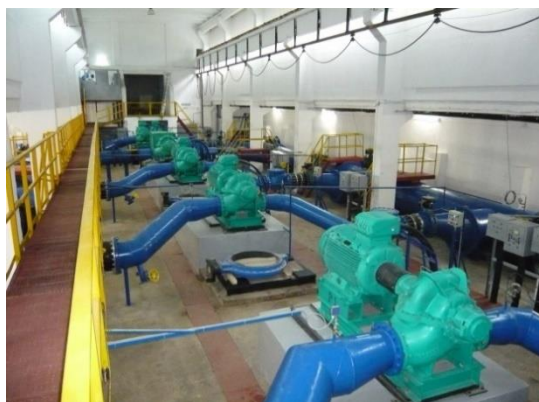
Uzina de apă nr.2- Sala pompelor (foto 2)
